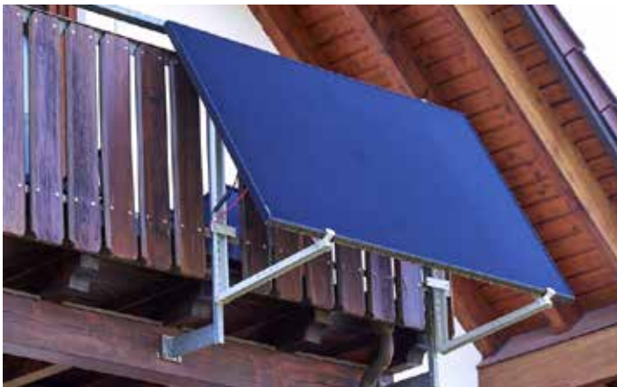
Um die Vorteile und Grenzen einer Balkon-Photovoltaik-Anlage geht es im Vortrag im Bürgersaal in Ellmendingen. Foto: keep gGmbH
